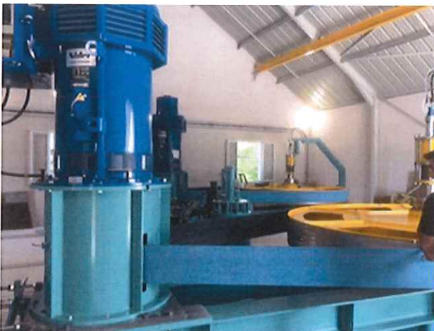
La turbine sera bientôt en service
